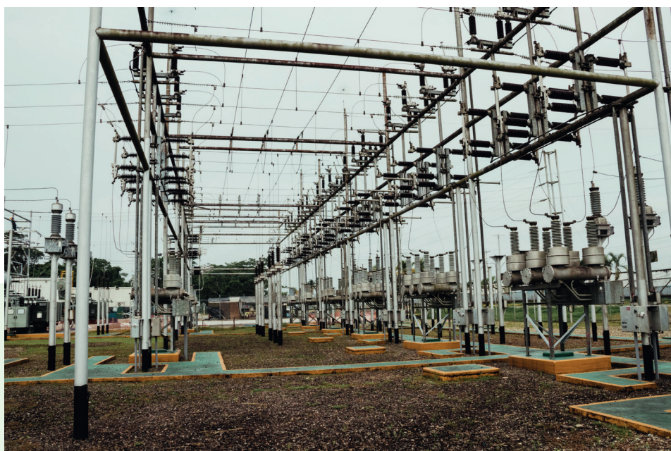
Figura 27: Exemplo de estação rebaixadora de energia elétrica.
