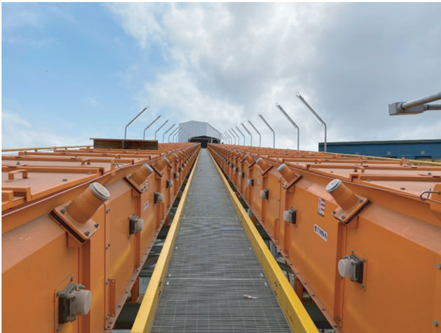
Figura 9: Correias transportadoras de graneis sólidos tipo enclausuradas, em galerias metálicas abertas.
