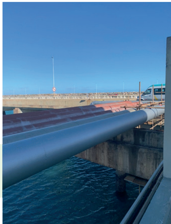
Figura 18: Exemplo de tubulação de GLP na interligação com pier
