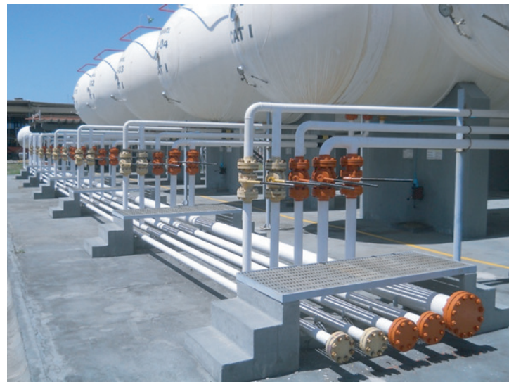
Figura 17: Exemplo de tanque de armazenamento de GLP
